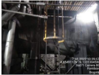
Fotografía 3. Caldera carbón 300 BHP
