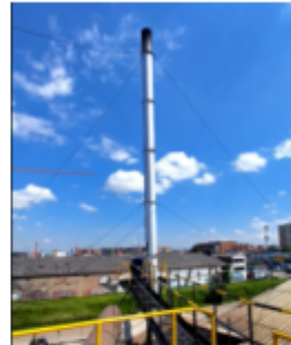
Fotografía 4. Ducto de la caldera objeto de estudio.
