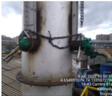
Fotografía 7. Puertos de muestreo ducto de la caldera carbón 300 BHP
